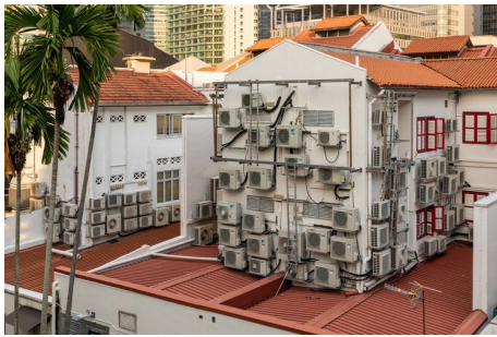
An Fassaden montierte Klimaanlage in Singapurs Chinatown, 2019.
